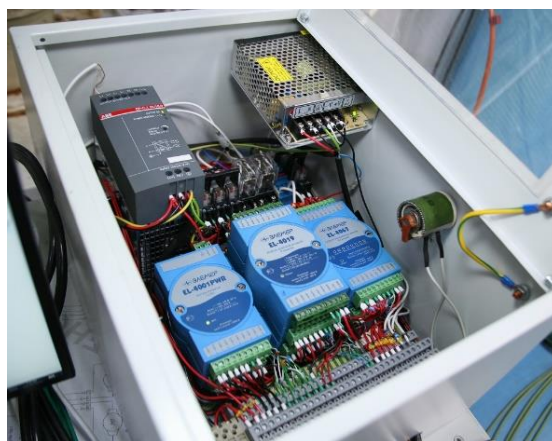
Рис. 3. Общий вид программно-технического комплекса: а – рабочее место оператора; б – электрический шкаф стенда МТК
